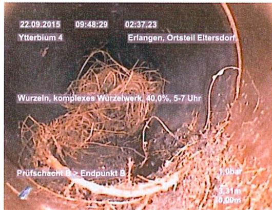
Abb.3: TV-Kamera Inspektion 2015 der Steinzeugleitung
