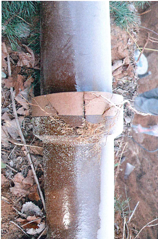
Abb.11a: Zustand der Steinzeugmuffe bei Position 3,3 m nach Aufgrabung
